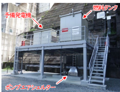
【 予備発電機設備：同敷地内 】
