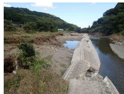
妙之谷川 護岸被災状況
