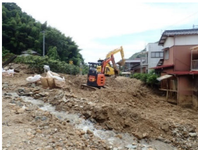
南柏川 土石流による人家被災状況
