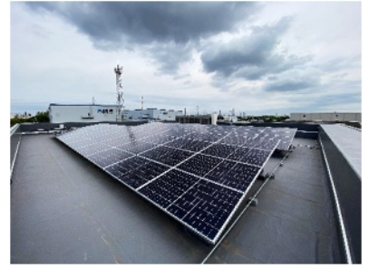
屋上 太陽光発電設備
